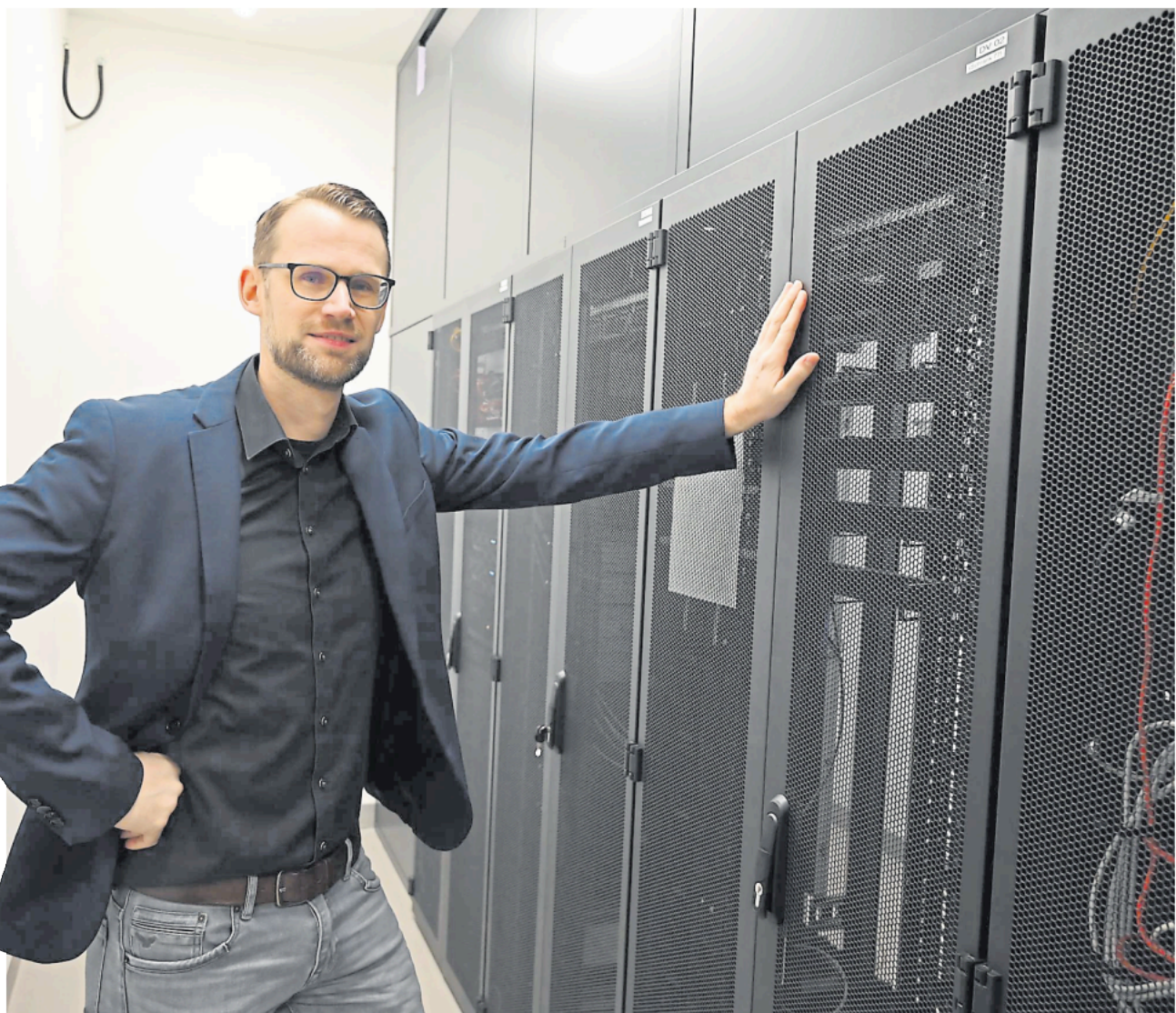
Jan Bornhöft vor den Serverschränken im neuen Rechenzentrumcontainer. Die IT-Infrastruktur der Stadt ist damit für die Zukunft ausgerüstet. Foto: Thode
